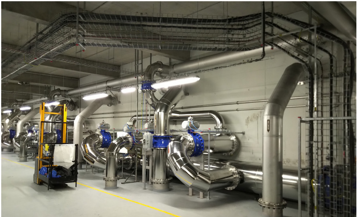
▲ Technologisches Umfeld eines Maschinenraums.
