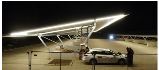
▲ Ladestation eines photovoltaischen Kraftwerks.
